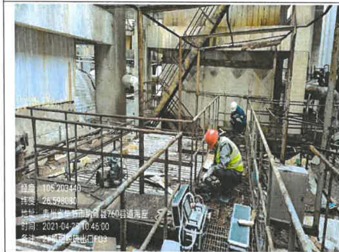
2#机组脱硝出口 FQ3
