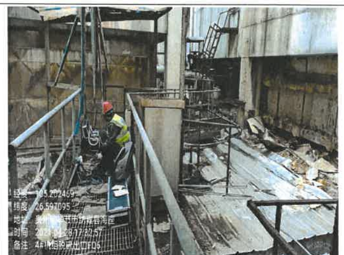
4#机组脱硝出口 FQ6
