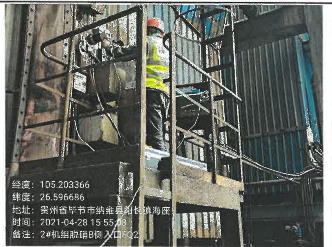
2#机组脱硝 B 侧入口 FQ2
