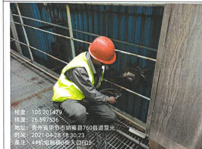
4#机组脱硝 B 侧入口 FQ5
